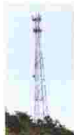
Torres de telecomunicaciones
